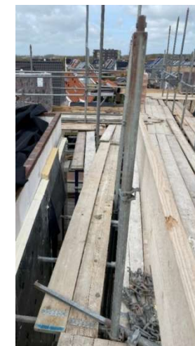
Afbeelding 22 Voorbeeld te grote ruimte tussen gevel en steiger
