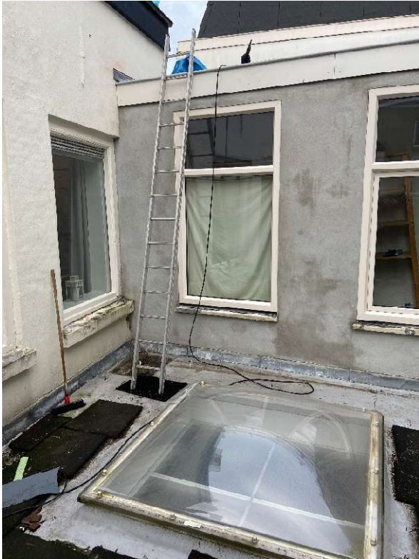
Afbeelding 10 Verkeerd ladderdeel, onveilige opstelling
