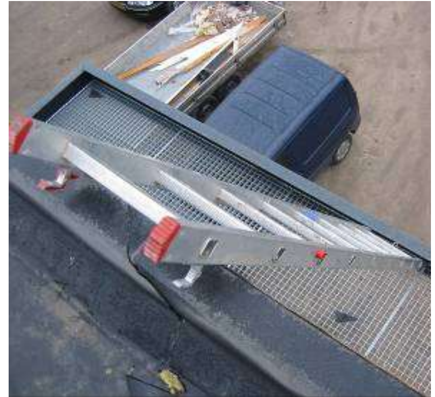
Afbeelding 12 Onderste boven, te korte ladder, niet geborgd en gevaarlijke opstelplaats
